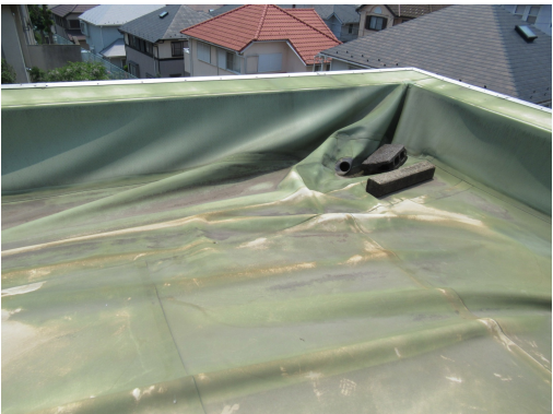
校舎屋上防水シートは固く波打ち雨漏りの危険性が大きくなっている。
