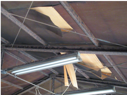
プレハブ倉庫は天井が垂れ下がり壁が落ち鉄の柱が折れている。
