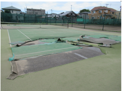
船橋啓明高校のテニスコート。人工芝が剥がれて怪我をする事故も起きています 11月7日・船橋啓明高校内
