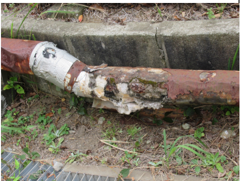
船橋啓明高校の水道管。管に巻いてある部分が朽ち果てたままになっていました 11月7日・船橋啓明高校内
