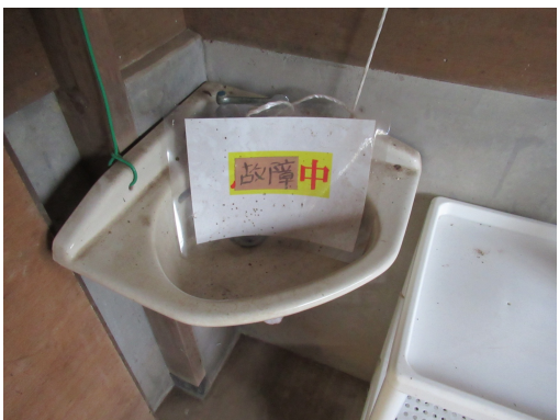
壊れていて使用禁止の水道。 11月8日・県民の森
