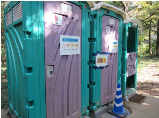
故障したままになっているトイレ。 11月8日・県民の森
