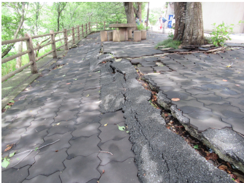
大きなひび割れが生じて危険な長津川調節池の展望台 11月7日・長津川調節池
