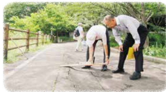
7月7日 地元の日本共産党地域支部と長津川調節池の遊歩道の段差やびび割れを調査する丸山慎一県議(右)
